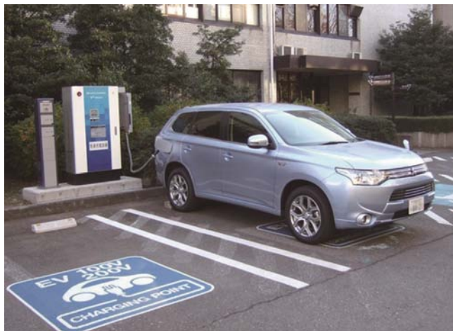
図 5 電気自動車の充電ステーション
